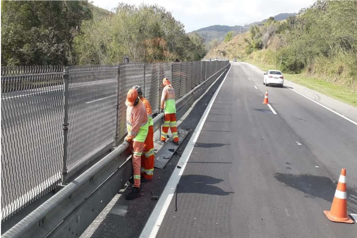
FOTO 07 - Dispositivo de Segurança - Km 15+500 Norte
