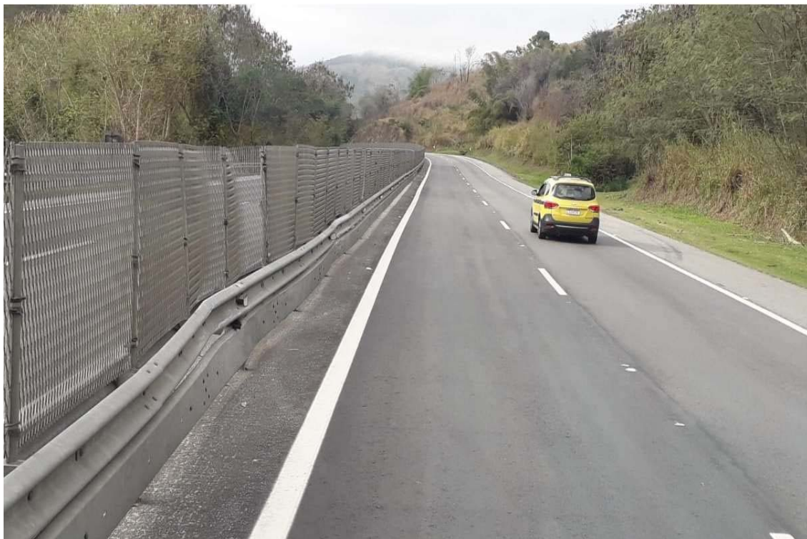
FOTO 06 - Dispositivo de Segurança - Km 15+500 Norte F1
